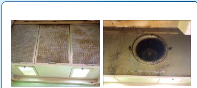
レンジフード内部ファン：油汚れ
